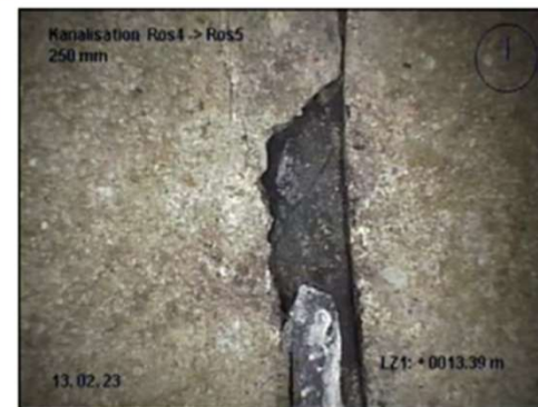
13.30 m Foto 3 Fehlende Scherbe / Wandungsteil an der Rohrverbindung 10 bis 2 Uhr
