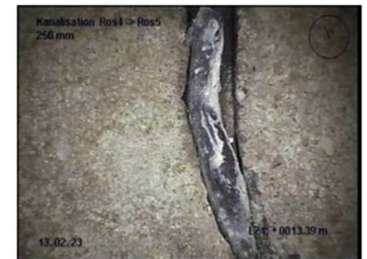
13.30 m Foto 4 Einragendes Dichtungsmaterial an der Rohrverbindung 9 bis 11 Uhr
